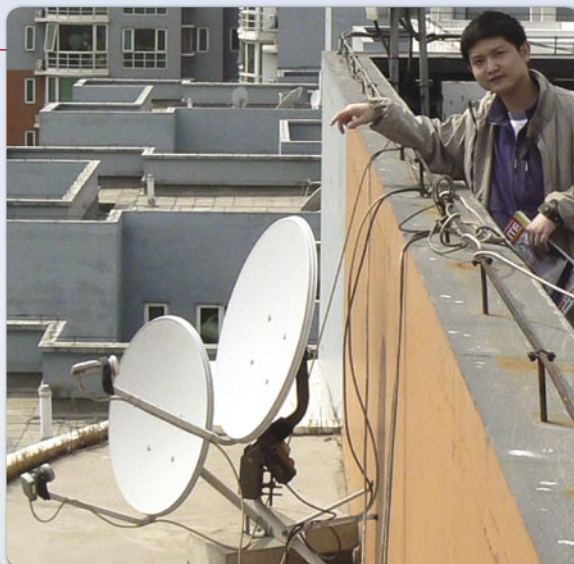
■ Antena tambahan terpasang pada sisi dinding: antena 75cm mengarah ke 134o BT dengan antena 60cm menggunakan motor MOTECK.
